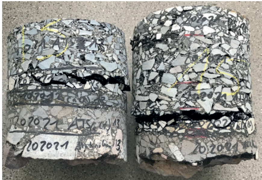
Bild 2: Mehrschichtige Überbauung geschädigter Altbeläge
